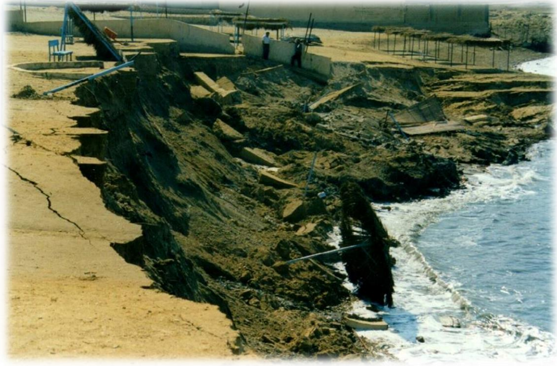
الشكل يوضح انهيار جزء من استراحة الضمان الاجتماعي على شاطئ البحر الميت
